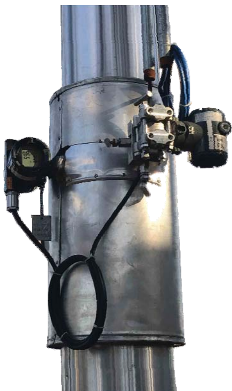
图 2 FVC 流量计在管道上的安装
